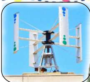
自宅屋上に設置されている小型風力発電
